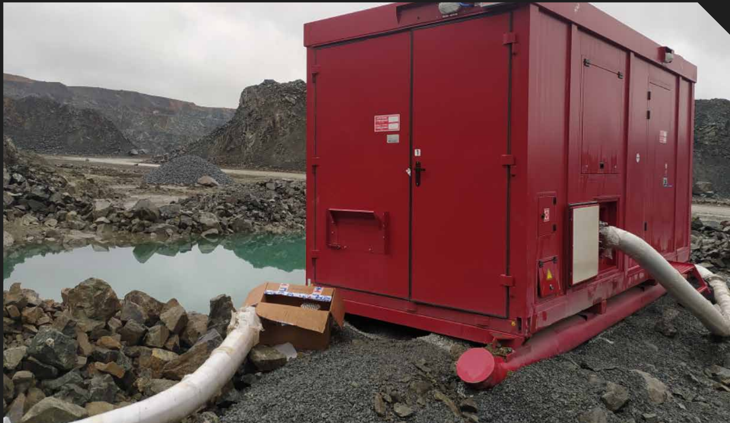
Передвижная ДНУ с насосом в кислотостойком исполнении для перекачивания агрессивных сред, Волковское месторождение
