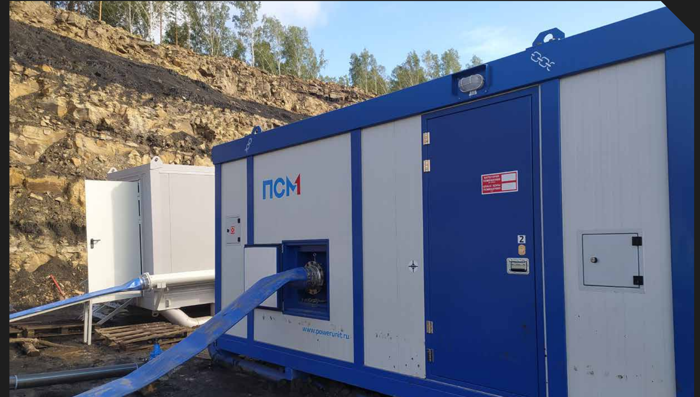
Передвижная резервная ДНУ водоотлива для угольного месторождения, ООО «РАЗРЕС ИРЕТСКИЙ»
