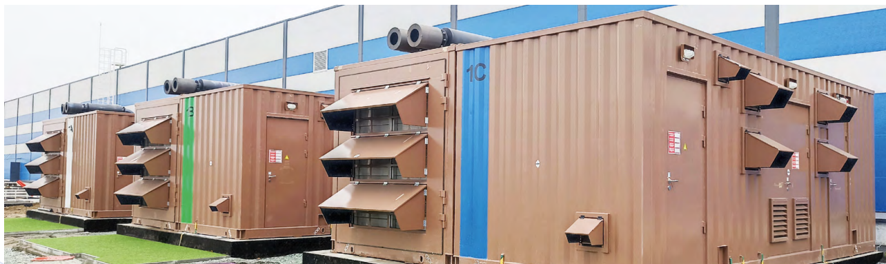
Размещение энергомодулей в паре с ДЭС. Дата-центр «Key Point», Новосибирская область
