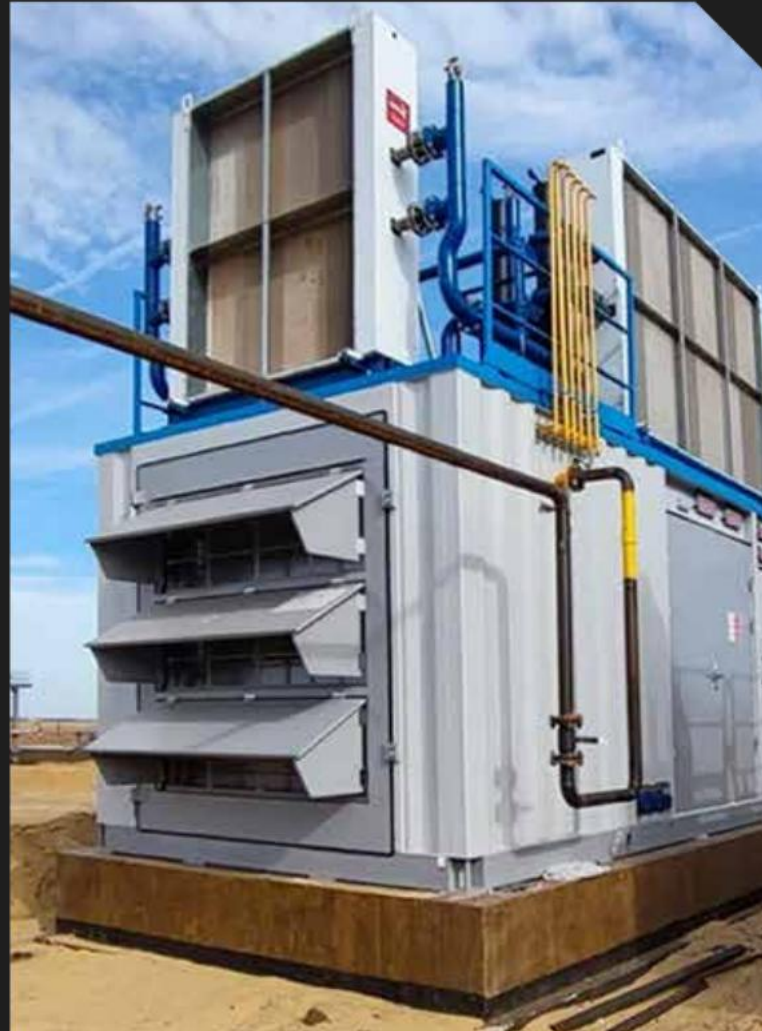
Gas gensets 燃气发电机组
