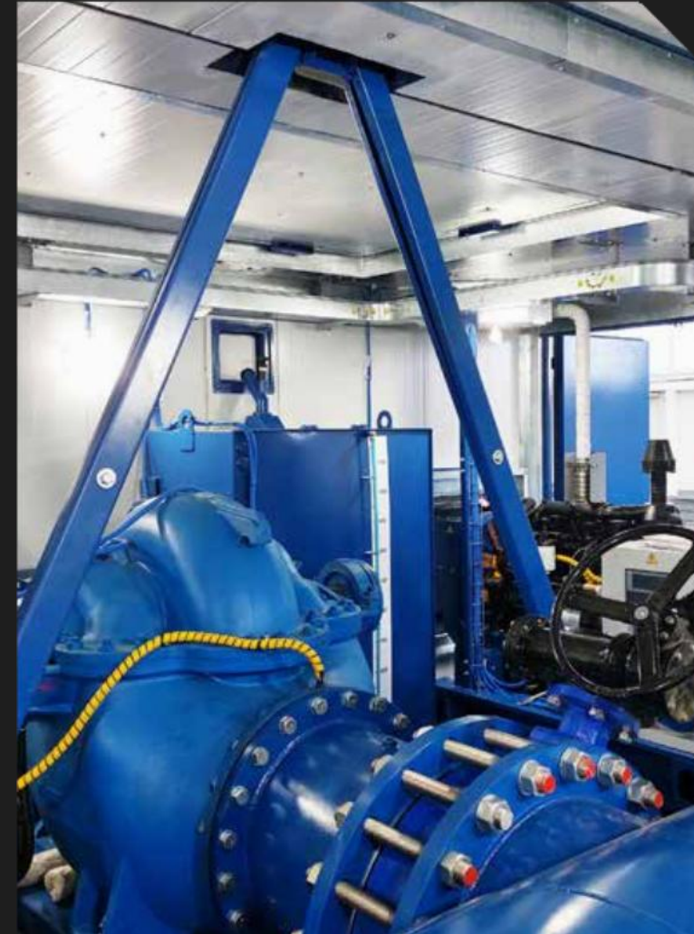
柴油泵机组 用于金矿
