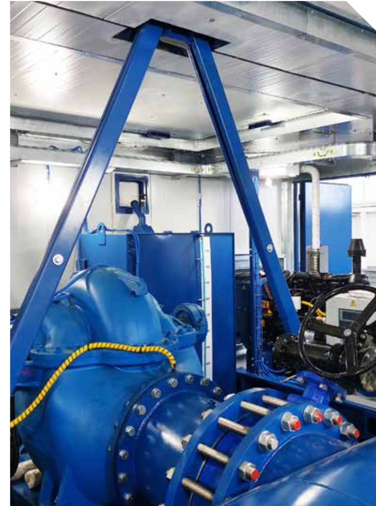
柴油泵机组 用于金矿
