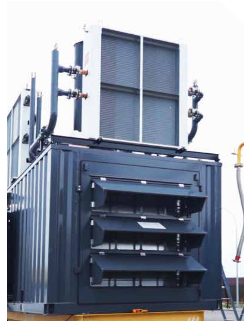
玻璃厂 1MW 燃气发电厂
