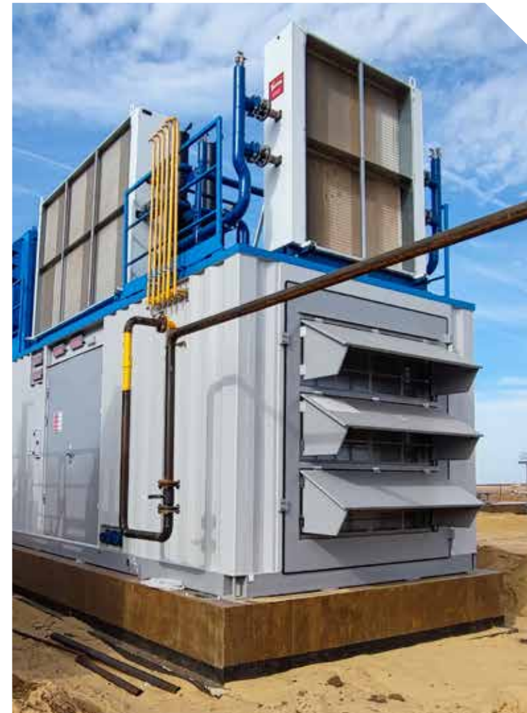
俄罗斯天然气工业股份公司 3.5 兆瓦燃气发电厂
