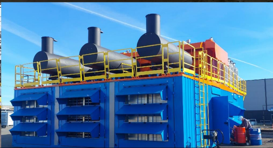
9 МВт. ЗРУ и КХТ. РусГидро
