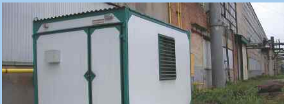
ADV-460 и ADV-300 для резервного энергоснабжения объектов на заводе ТольяттиАзот
