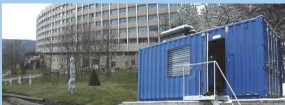
ADV-500 (2 шт) и ADV-400 как аварийный источник электроснабжения санатория «Заря» г. Кисловодск
