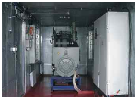
внутренний вид контейнерной электростанции
